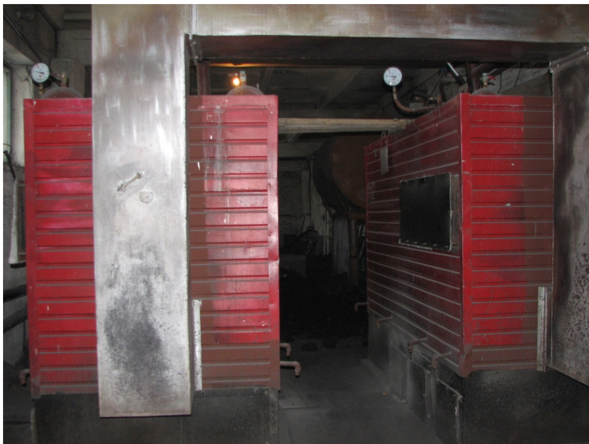
Рисунок 1.2 – Котлы «КВс-1,45», установленные на котельной с. Кочневка
