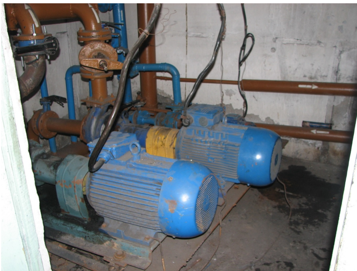
Рисунок 1.3 – Сетевые насосы котельной с. Кочневка
