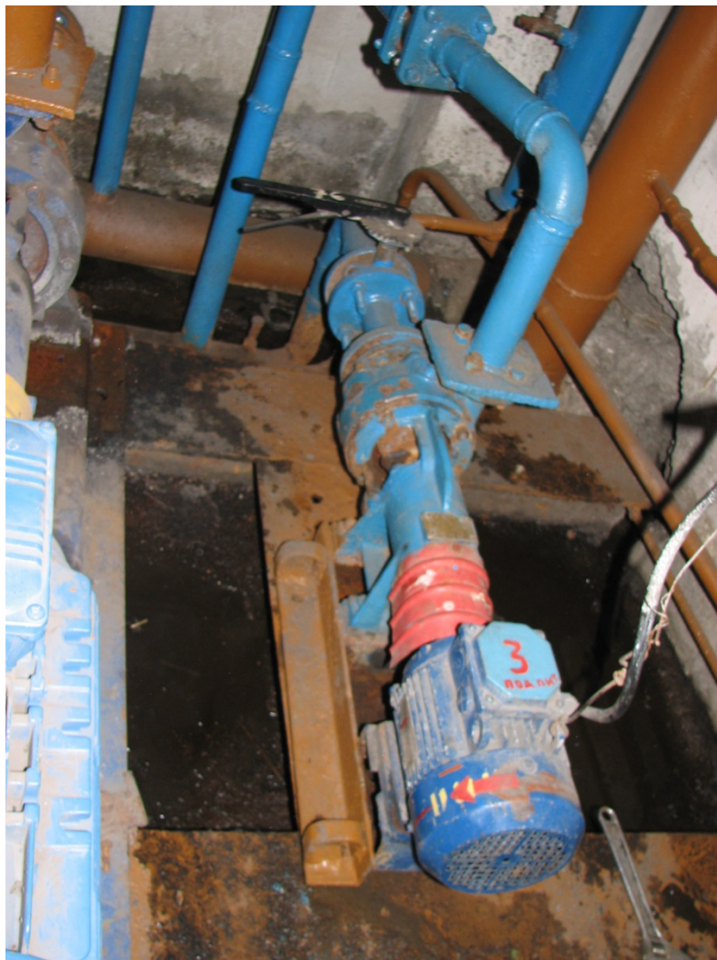
Рисунок 1.4 – Подпиточный насос котельной с. Кочневка
